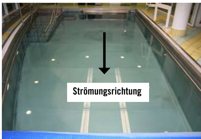
Abbildung 1: Bewegungsbecken mit Strömungskanal.
